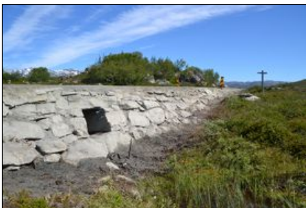
VEGMURAR: Gamle Strynefjellsveg er ein chaussé som er lagt på skrånande tørrmura vegmurar og fyllingar som er tilpassa terrenget.
